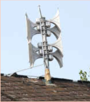
Auf dem Rathaus in Bad Marienberg ist seit kurzem eine der Sirenen installiert. Foto: © Westerwaldkreis/ Carolin Faller
