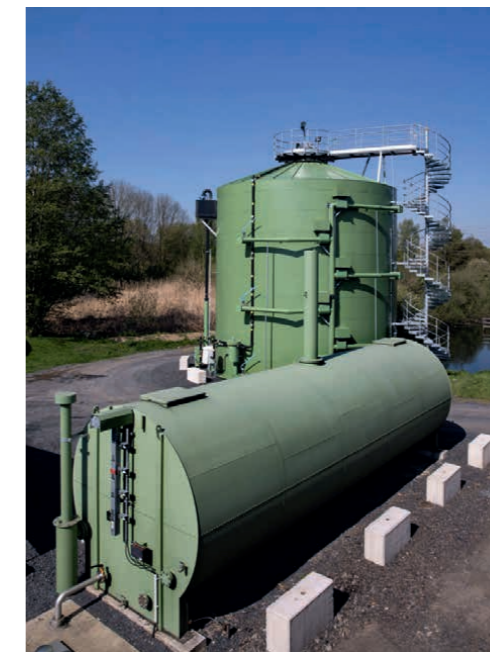
BHKW im Löwenbad mit Pufferspeicher im Vordergrund, Quelle: Verbandsgemeindewerke Hachenburg, Betriebszweig Energieversorgung
