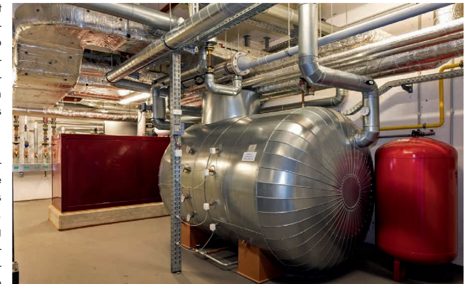
BHKW im Löwenbad mit Pufferspeicher im Vordergrund, Quelle: Verbandsgemeindewerke Hachenburg, Betriebszweig Energieversorgung
